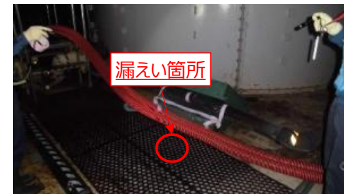
5・6号機フランジタンクからの漏えい
