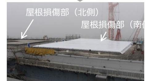
3号機タービン建屋・屋根状況 【流入防止堰・雨水カバー (南側) 設置完了】 〔西側から撮影〕
