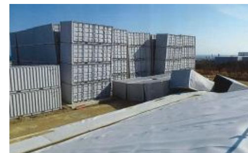
瓦礫保管エリアコンテナ傾き及び転倒
