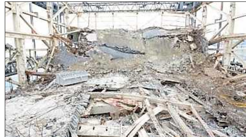
崩落屋根の状況
