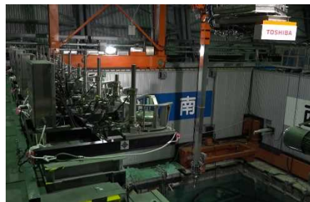
オペレーティングフロアの様子
