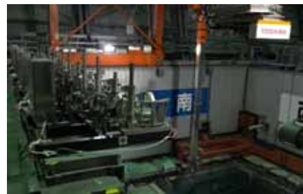
オペレーティングフロアの様子
