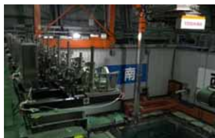
オペレーティングフロアの様子
