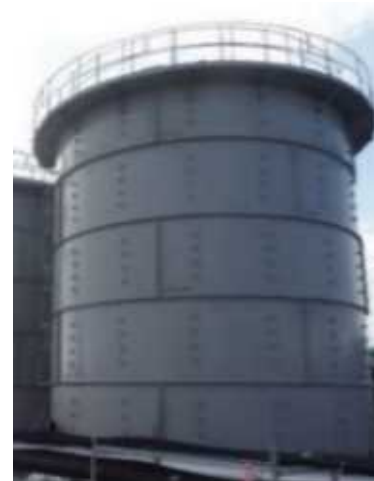
フランジ型タンク
