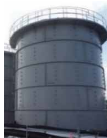
フランジ型タンク
