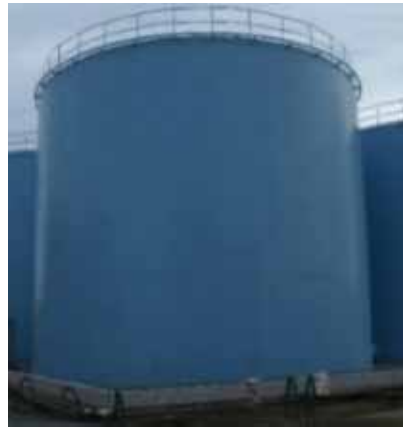
溶接型タンク
