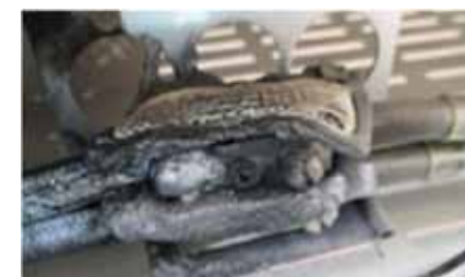
ブレーキレジスタ内の損傷（5月12日）
