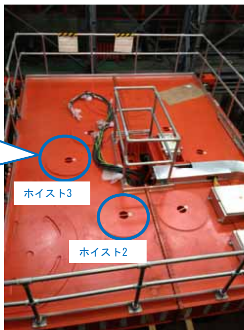
燃料取扱機トロリ上部
