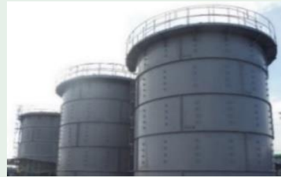
フランジ型タンク
