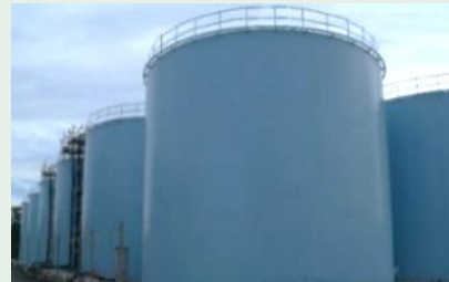
溶接型タンク
