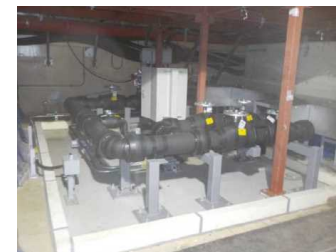
<2-7. 4号機滞留水浄化配管>
