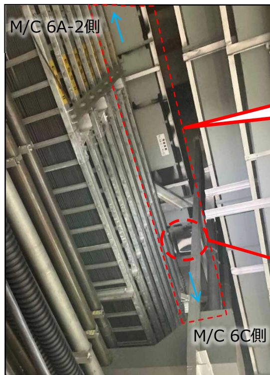
相非分割母線(見上げた状況)
