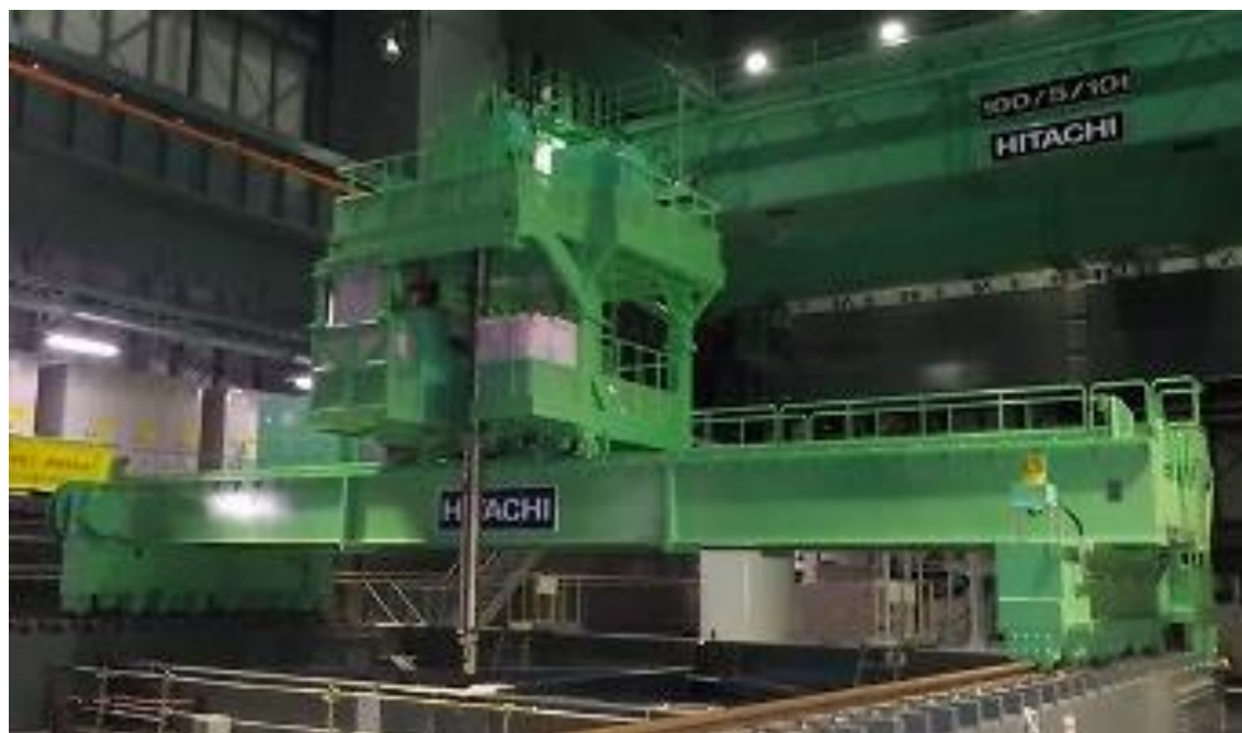
有効活用する4号機燃料取扱機
