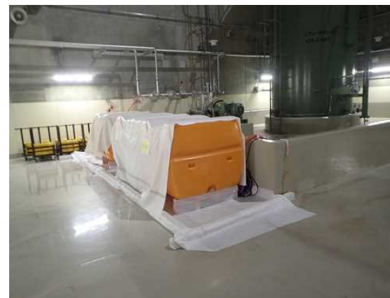
ローリータンク（3月14日撮影）
