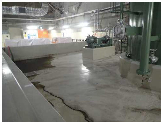
スプレータンク堰内（3月14日撮影）
