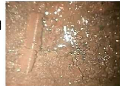
2号機ペDESTAL底部の状況 (2018年PCV内部調査)
