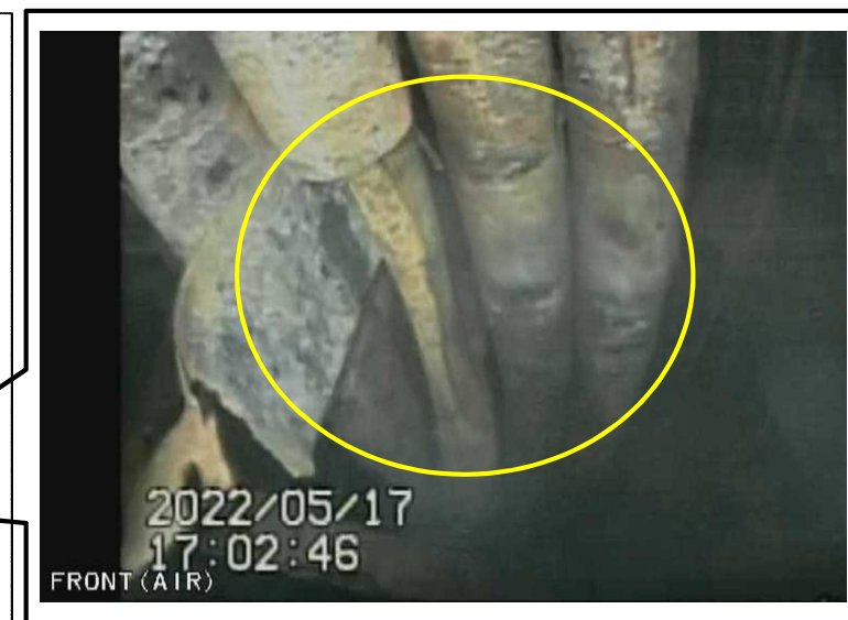
写真2. D/W内配管の状況
