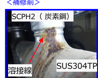
<⑫の外表面腐食・補修状況>
