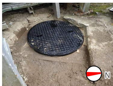
マンホール蓋 (②)
