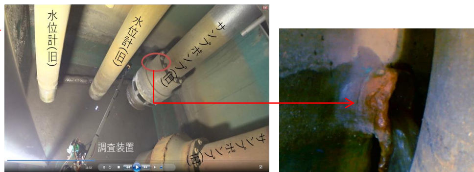
(1) ピット南東側壁に確認された配管からの流入状況
