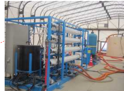
淡水化装置（RO装置）
