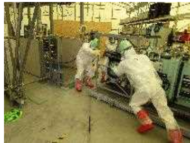
堆積物除去装置 （低圧水）設置
