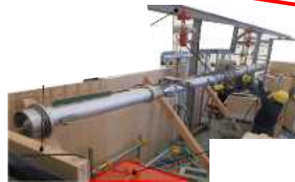
スプレー治具設置 ※X-53ペネに接続
