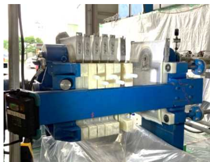
脱水処理(脱水物取出し工程)
