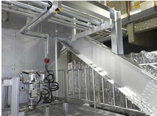
焼却炉室共通架台
