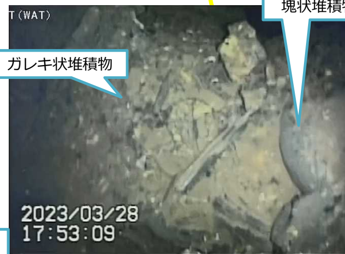
写真3.ペDESTAL内開口付近堆積物
