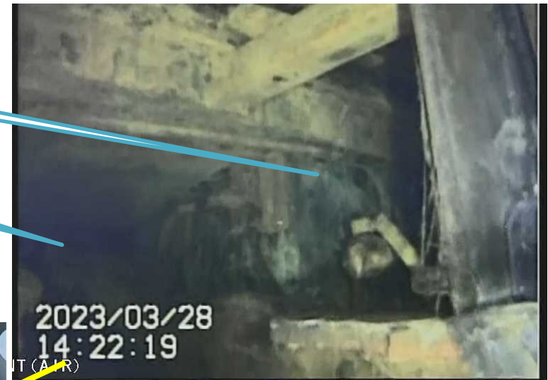
写真3.ペDESTAL開口部右上側壁面部
