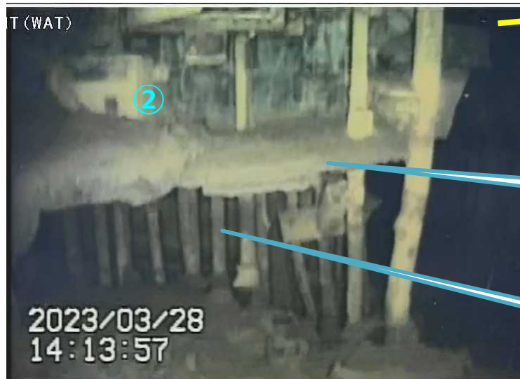
写真2.ペDESTAL開口部左下側壁面部
