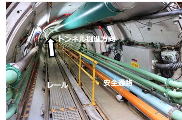
トンネル内部安全設備の整備状況
