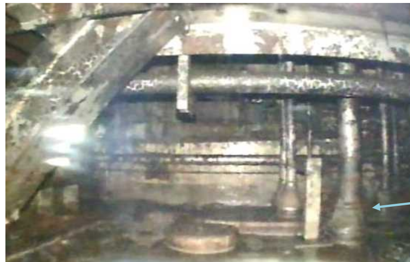
T.P.-0.8m（床面）~T.P.+1m付近：床面に水溜りやにじんでいる状況無
