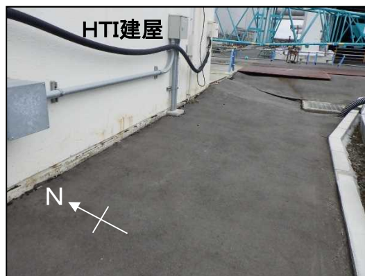
HTI建屋南側沈下状況
