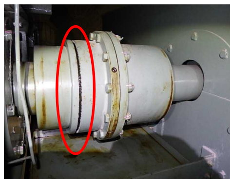
ギアカップリングカバー損傷部
