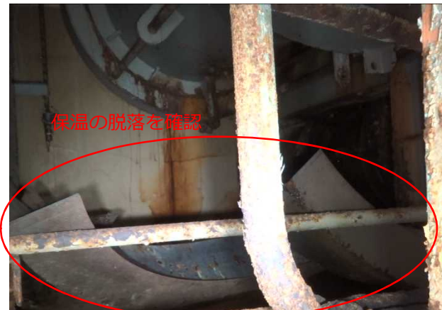
主蒸気配管B
