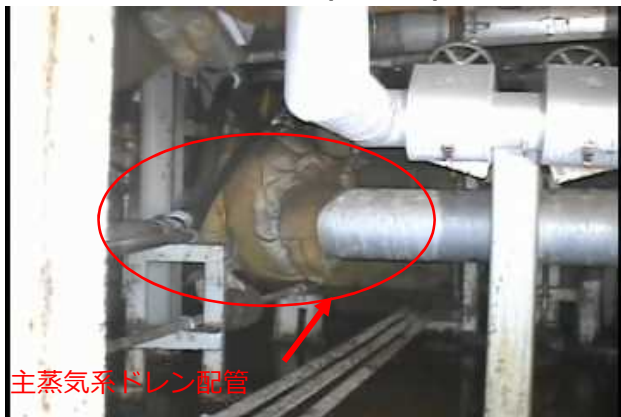
主蒸気系ドレン配管
