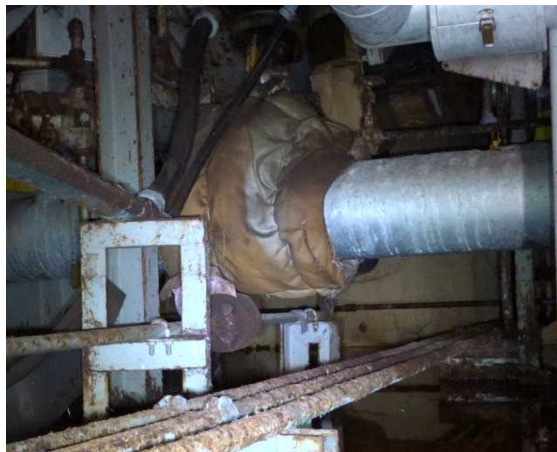
主蒸気系ドレン配管
