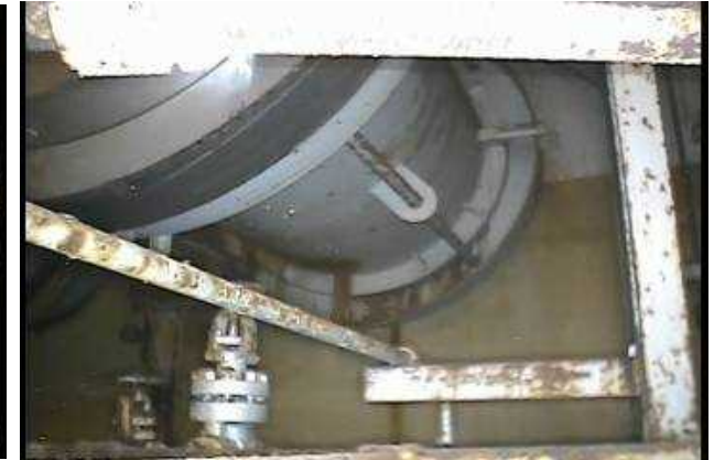
主蒸気配管C
