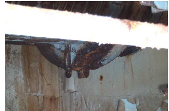
主蒸気配管C
