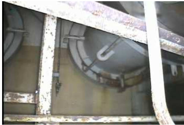
主蒸気配管B
