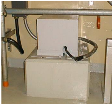
6号機の既設地震計
