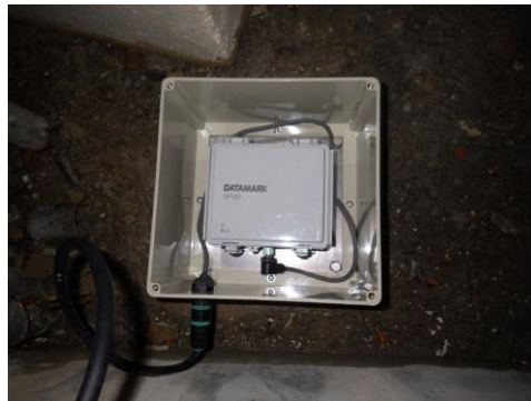
3号機に設置した地震計 (1階レベル)
