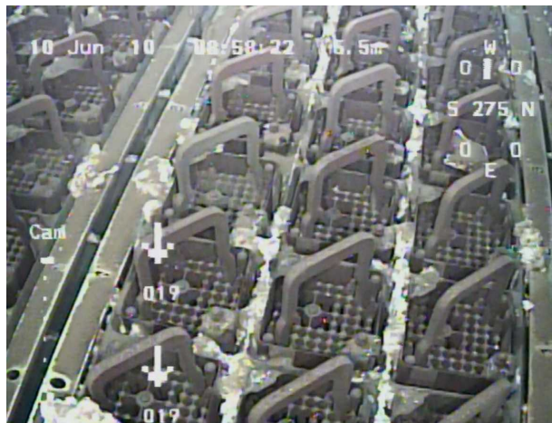
【SFP内の燃料、燃料ラック上部の様子】
