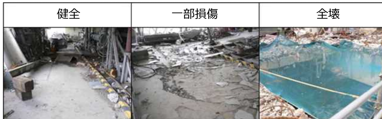
損傷度分類の例
