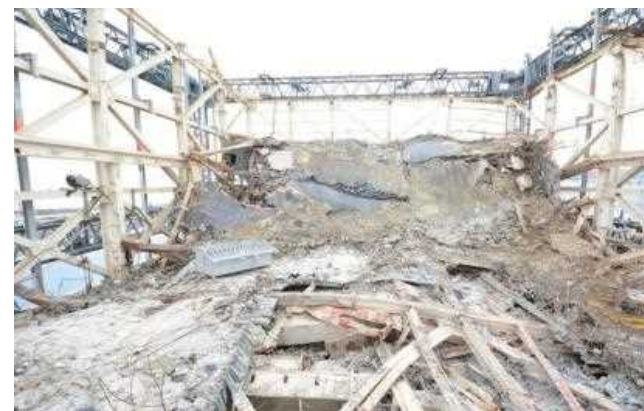
南側崩落屋根の状況
