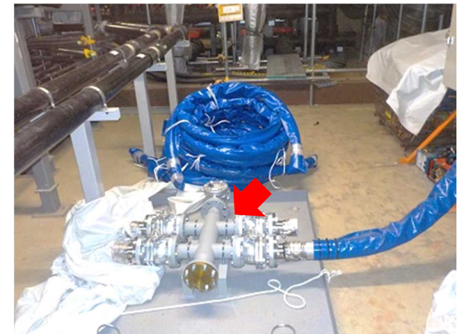
仮設ラインヘッダー
