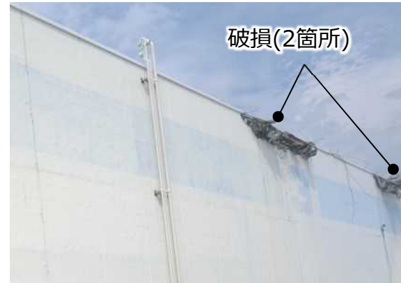
破損パラペット
