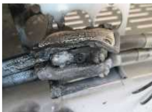
ブレーキレジスタ内の損傷 (5月12日)
