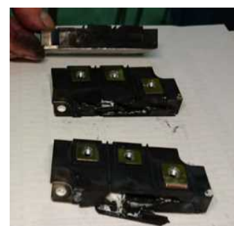
整流器の損傷 (4月5日)
