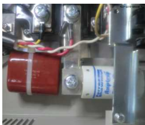
ヒューズの損傷 (4月25日)
