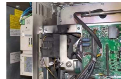
主巻インバータ内部の煤 (5月11日)
