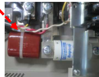
損傷の確認されたヒューズ (4月25日)
