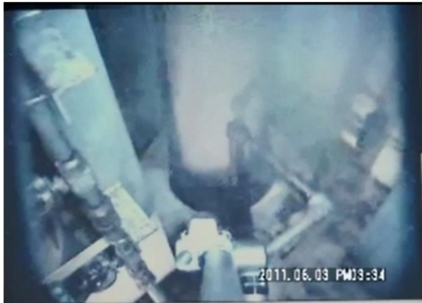
図 1.3 1号機 R/B1 階南東の床貫通部で確認された湯気（2011年6月）[3]
