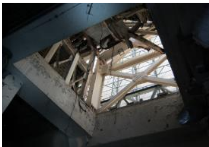
図7 水素爆発後の機器ハッチ部（4階から5階を見上げて）
