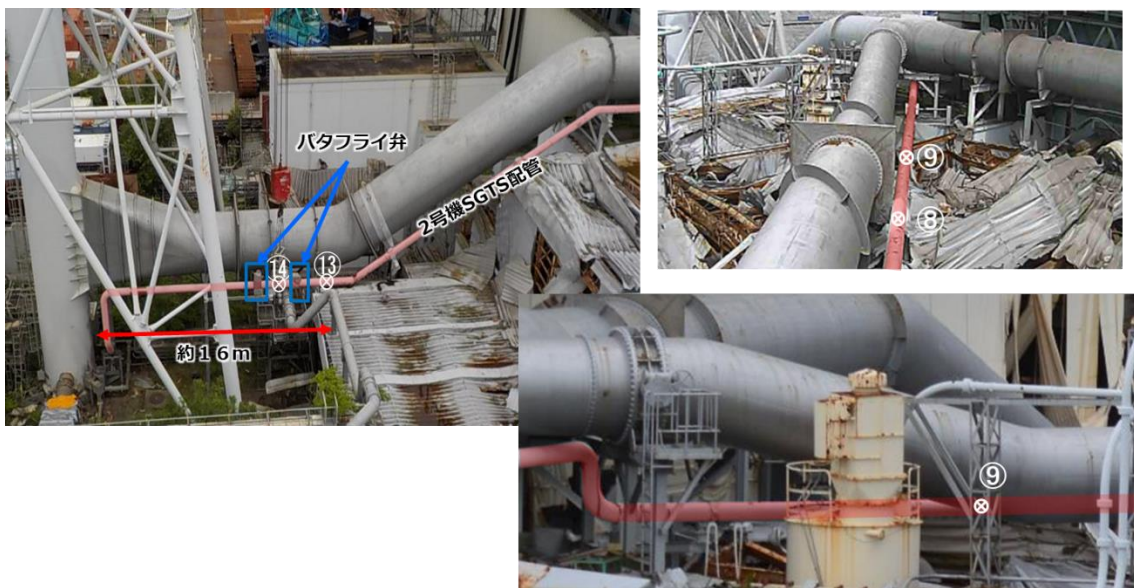
図 2- 44 SGTS 配管近傍で高線量率が確認された箇所 （図中の番号は図 2-43 の測定ポイントと対応） [2-25]
