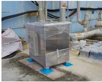
ミュオン測定装置設置 (小型装置, 約1m×1m×高さ1.3m)
