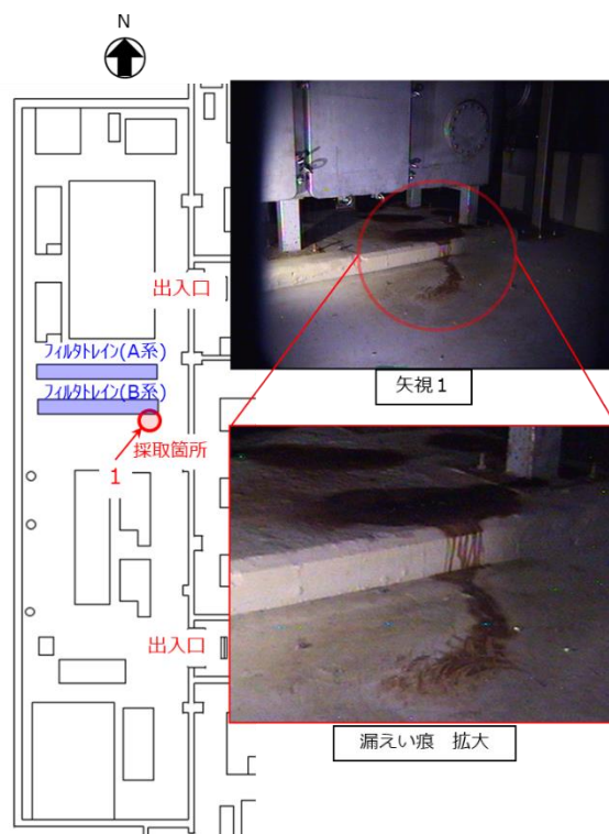
図 3-16 フィルタトレイン B 系下流側で確認された漏えい痕 [3-9]
