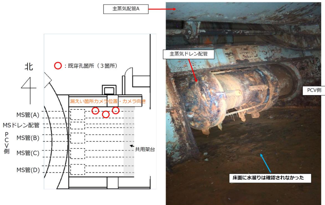
図 4-8 主蒸気配管 A 調査結果 (2022 年 6 月) [4-7]
