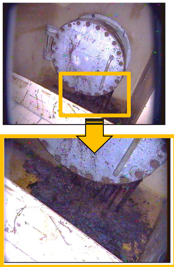
図 3-18 ペネトレーションフランジ部の溶融物の写真 [3-11]
