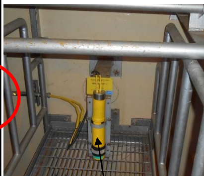
検出器（5号機の例）
