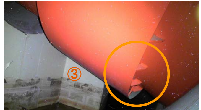
ベント管ベローズカバー下部
