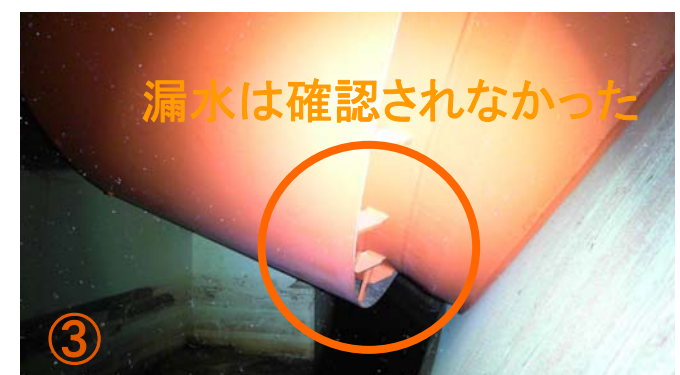
ベント管ベローズカバー下部
