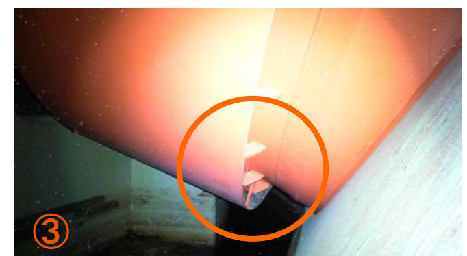
ベント管ベローズカバー下部
