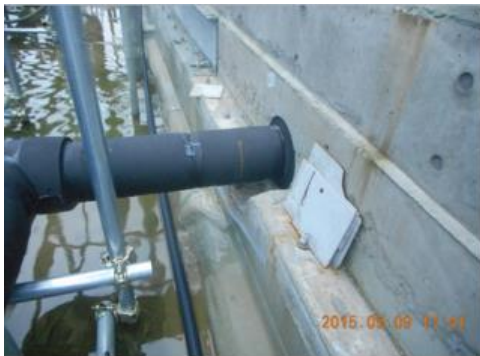
配管貫通部下部より漏えい (鉛筆1本程度の太さ)
