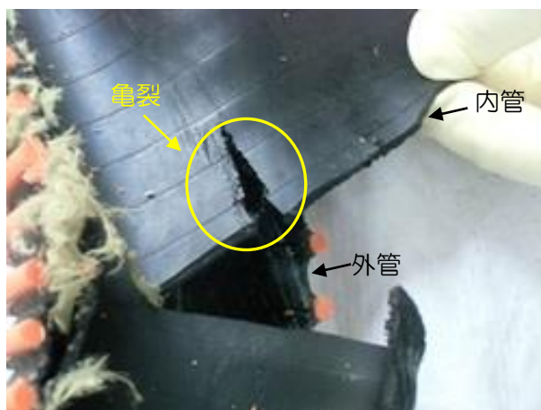
当該ホース亀裂・剥離写真
