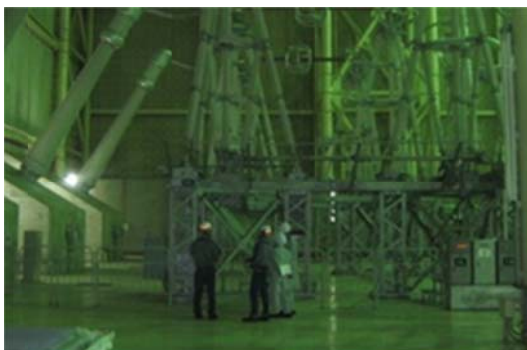
開閉所機器の確認
