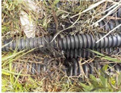
損傷したエフレックス管
