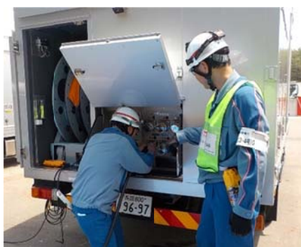
電源車の起動操作訓練
