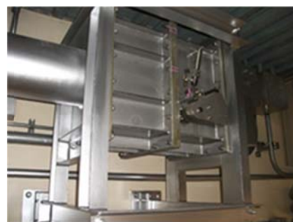
配管類の止水対策（フラップゲート）
