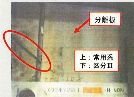
No. 70 分離板の隙間を貫通
