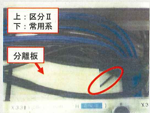
No. 16 分離板の隙間を貫通
