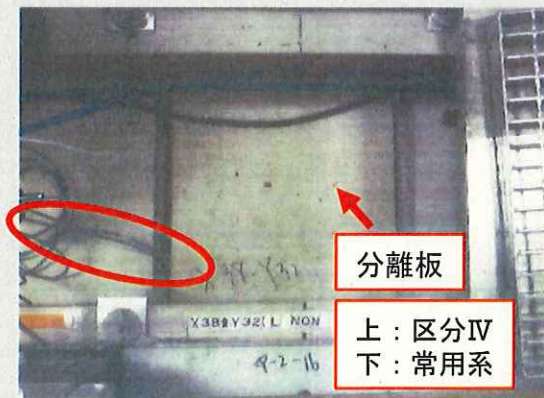
No. 23 分離板の隙間を貫通
