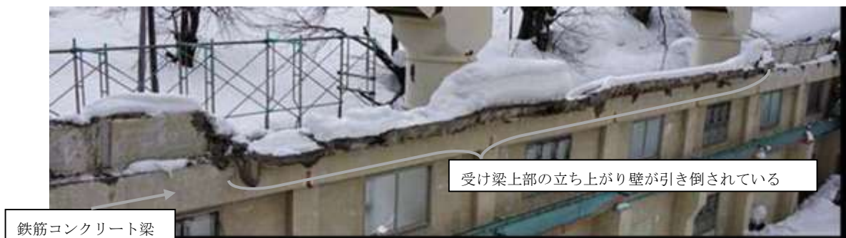
写真 3-1(10)：鉄筋コンクリート梁より上部の壁の破損状況(2015年2月撮影)
