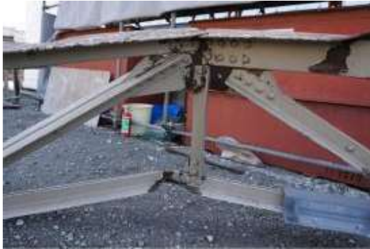
下弦材の曲がり③(2015年4月撮影)
