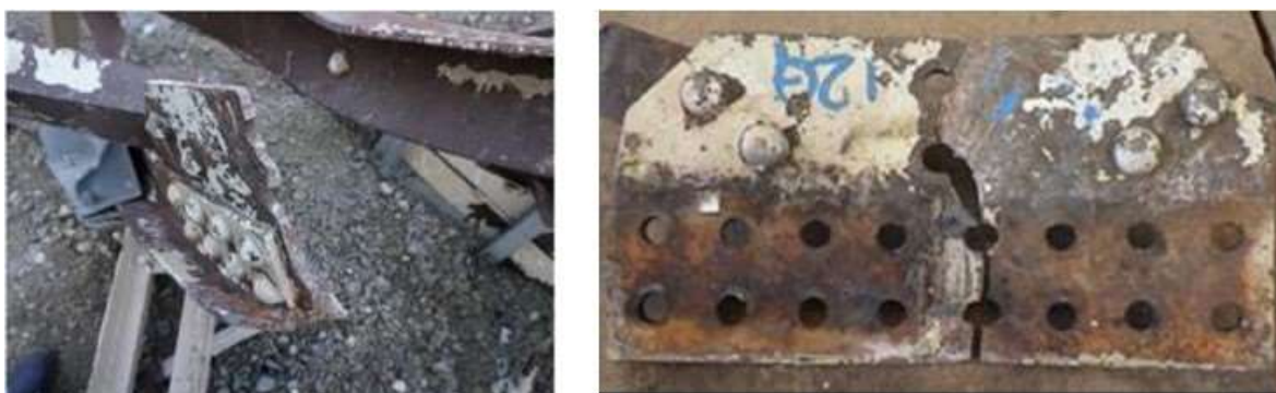
写真 3-2(2) : 下弦材ガセットプレートの破断(2015年4月撮影)
