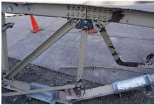
斜材の曲り①(2015年4月撮影)
