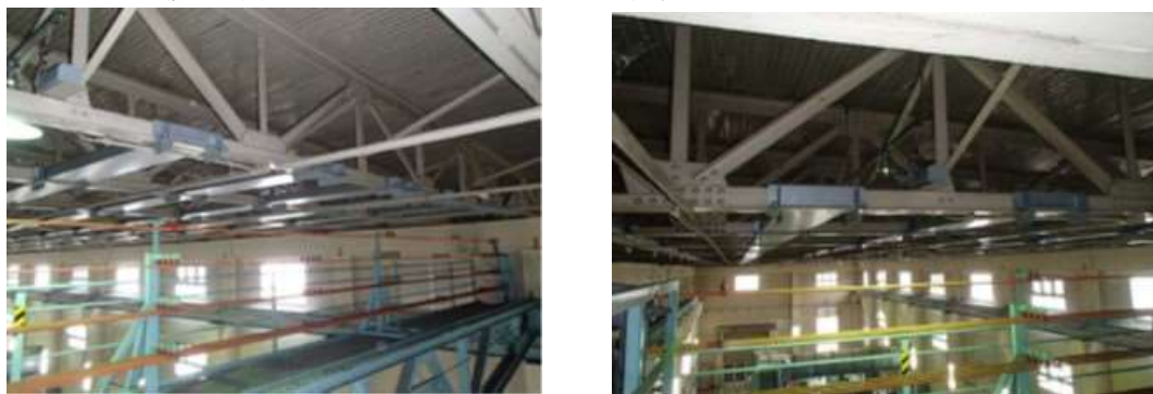
写真 1-2(1)：建屋点検時のトラス状況(2014年11月9日撮影)
