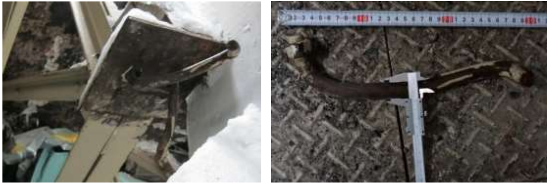
トラス支承部のアンカーボルト アンカーボルト詳細（落下時に変形） 写真 3-1(9)：トラス支承部のアンカーボルト破損状況(2015年2月撮影)
