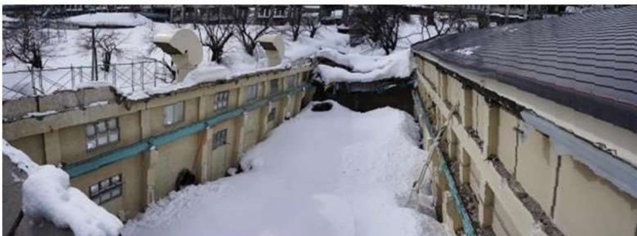
写真 3-1(4)：屋根落下状況（2015年2月撮影）
