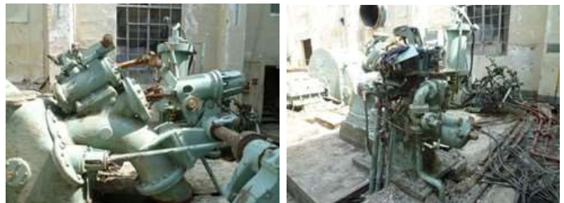
写真1-2(5) : 各水車関係の破損状態
