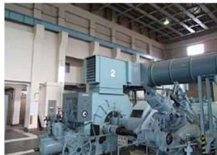
発電機室内観（北面）
