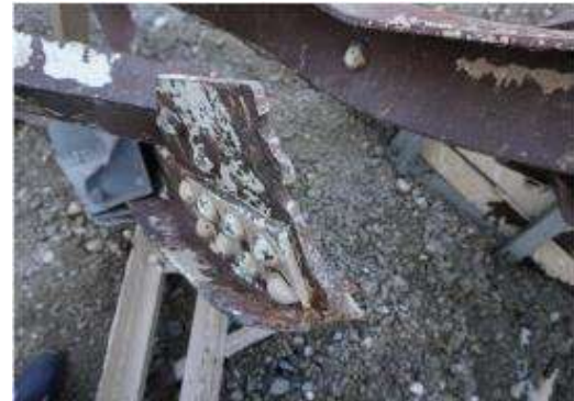
下弦材のガセットプレートの破断④ (2015年4月撮影)
