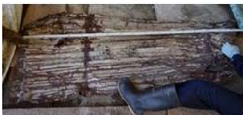
落下したキーストンプレート全体写真
