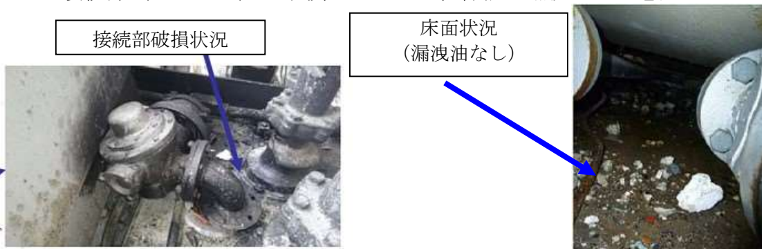
写真 1-2(10):No.2 変圧器破損と油漏洩の状況 (2015年1月27日撮影)
