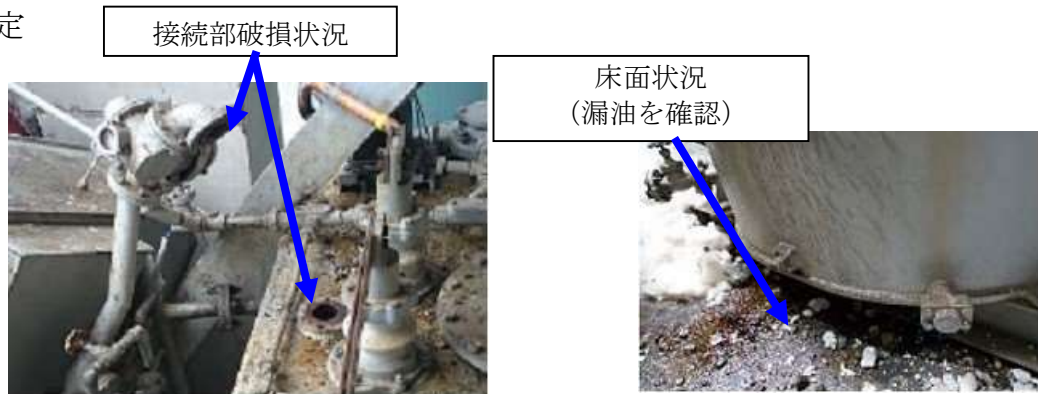
写真 1-2(11):No3.変圧器破損と油漏洩の状況（2015年1月27日撮影）
