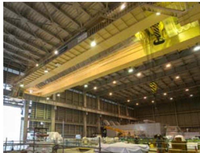
第2軸天井クレーン
