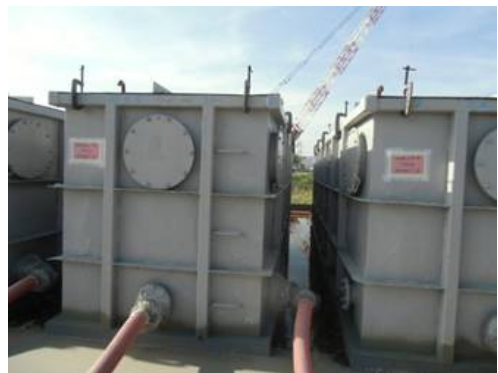
1000トンノッチタンク群 状況写真
