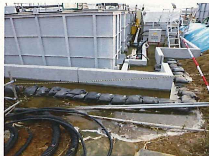
漏えいの状況（③エリア）
