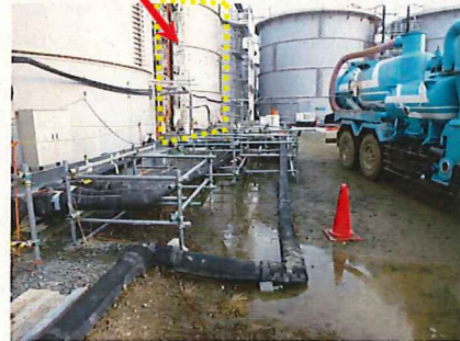
漏えいの状況（①エリア）
