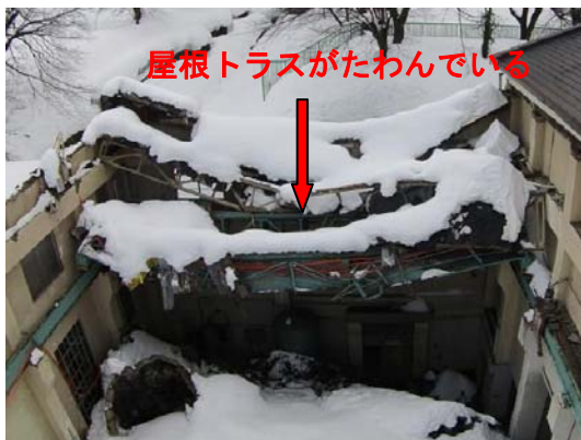
天井クレーン(東上空から)
