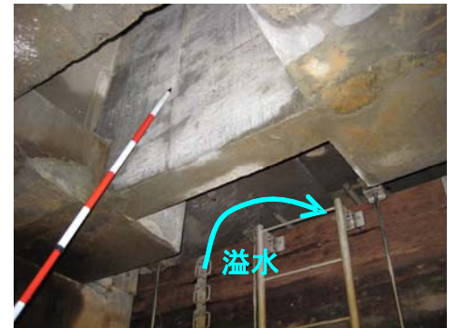
写真-2: 溢水箇所での水位上昇 (26号横坑)
