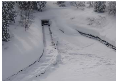
写真-4: 導水路出口への氷雪堆積
