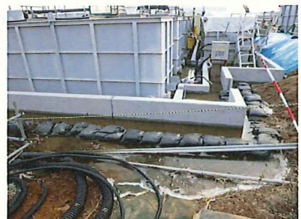
漏えいの状況（③エリア）
