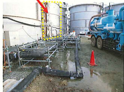
漏えいの状況（①エリア）
