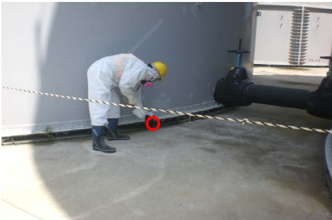
図2 No. 4タンク高線量箇所
