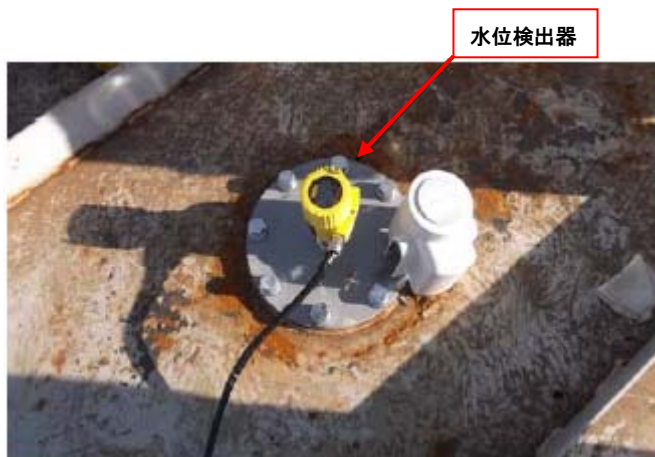
写真8 水位計設置状況
